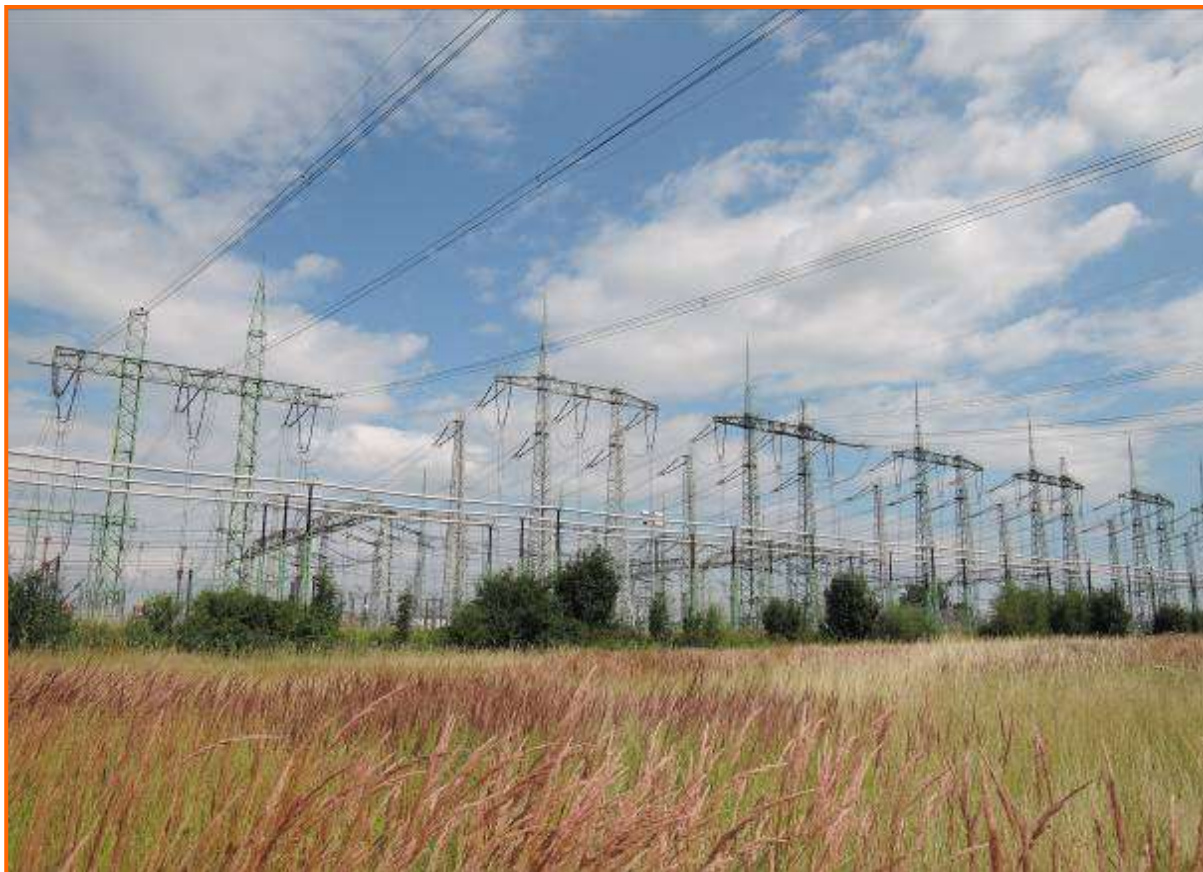
Obrázek č. 18: Transformační stanice v Nošovicích 62
